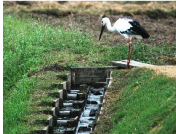
写真5. コウノトリの野生復帰の推進に向けた農地整備 水田に設置された魚道 (写真提供: 兵庫県但馬県民局地域振興部豊岡土地改良事務所)
