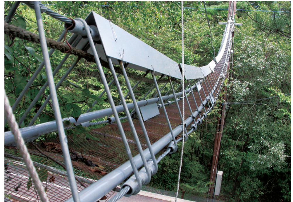
断面がトライアングル形状の吊り橋構造が特徴のアニマルパスウェイ Animal pathway suspension bridge with the distinctive triangular cross section.
